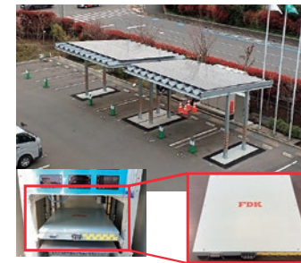
エクシオグループ様 グリッドフリーソーラーカーポート ＊ 停電時のシステム制御用のバックアップ電源
